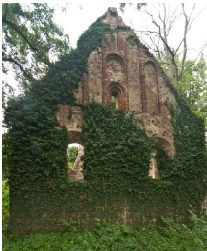
Ruina kościoła w Ziemomyślu
